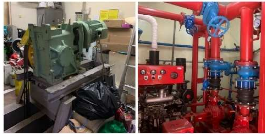
Gambar 5. Ruang Mesin Lift dan Ruang Pompa Air
