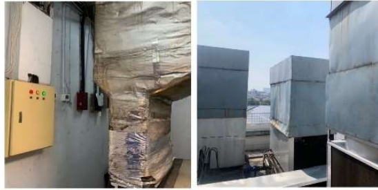
Gambar 3. Ruang AC Indoor dan Ruang AC Outdoor
