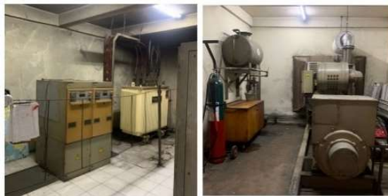
Gambar 4. Ruang Panel dan Ruang Genset
